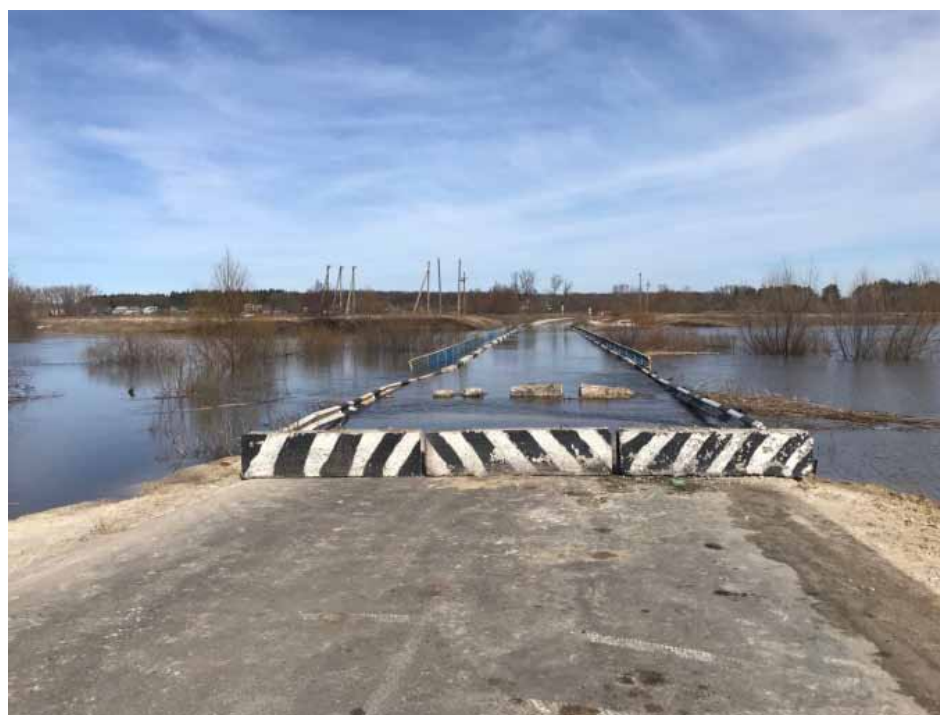
Рис. 15.34. Подтопление мостов (Льговский район)
