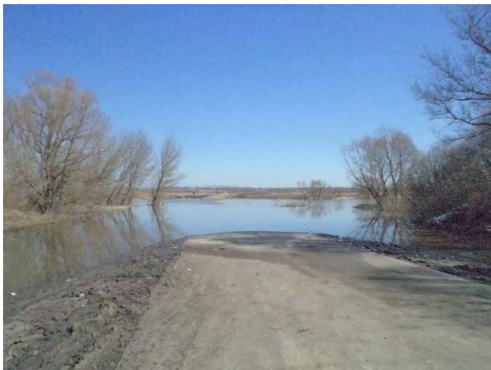
Рис. 15.35. Подтопление мостов (Солнцевский район)
